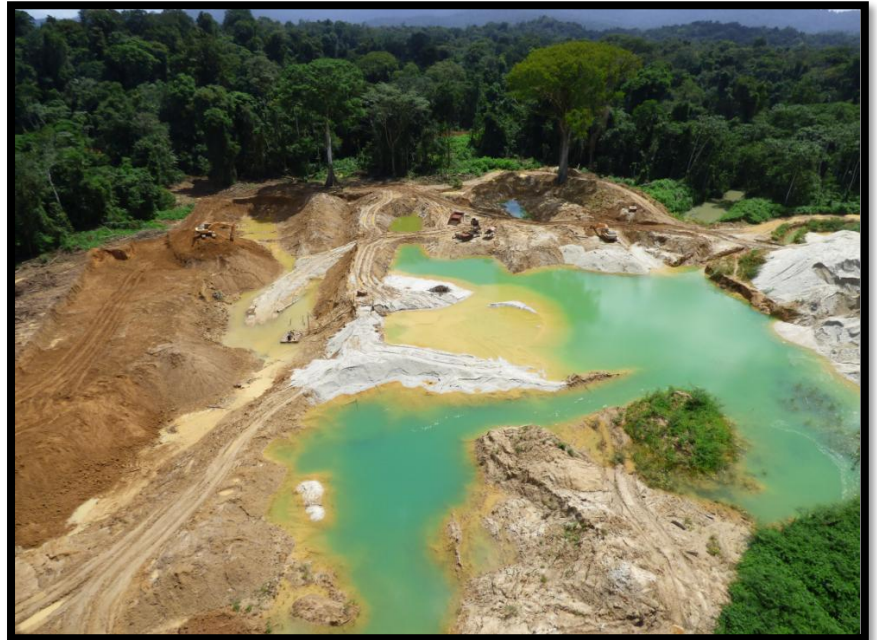
Chantier sans autorisation dans une réserve
